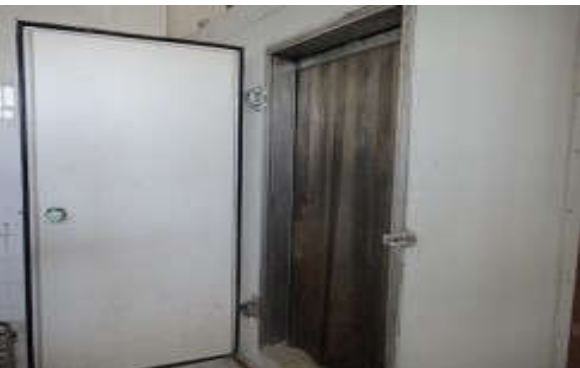
Kondisi cold room di RPH Kab. Kupang
